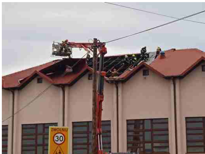
⚠ Zerwany dach na budynku szkoły w Piotrowicach
