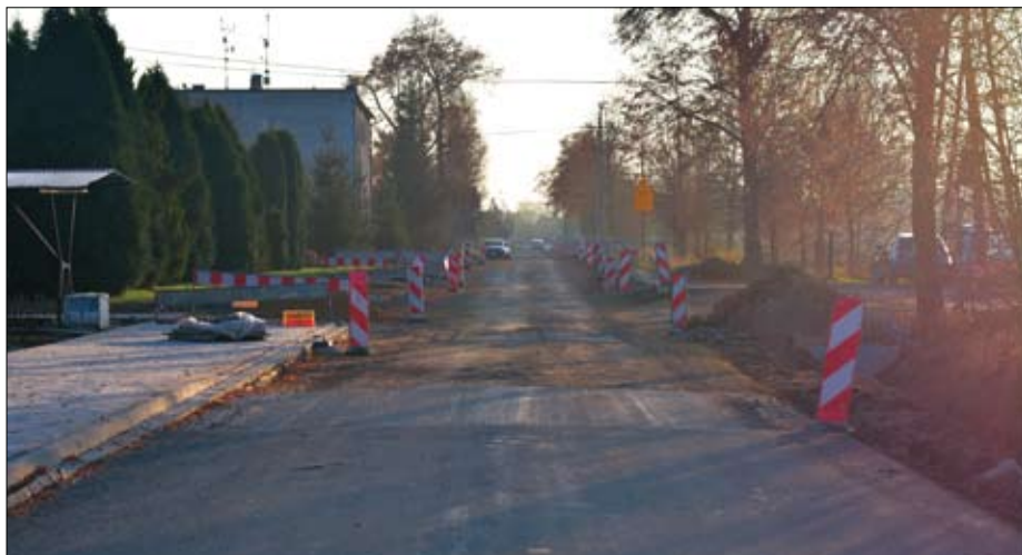
Tak wyglądała nasza droga powiatowa jeszcze w listopadzie.
